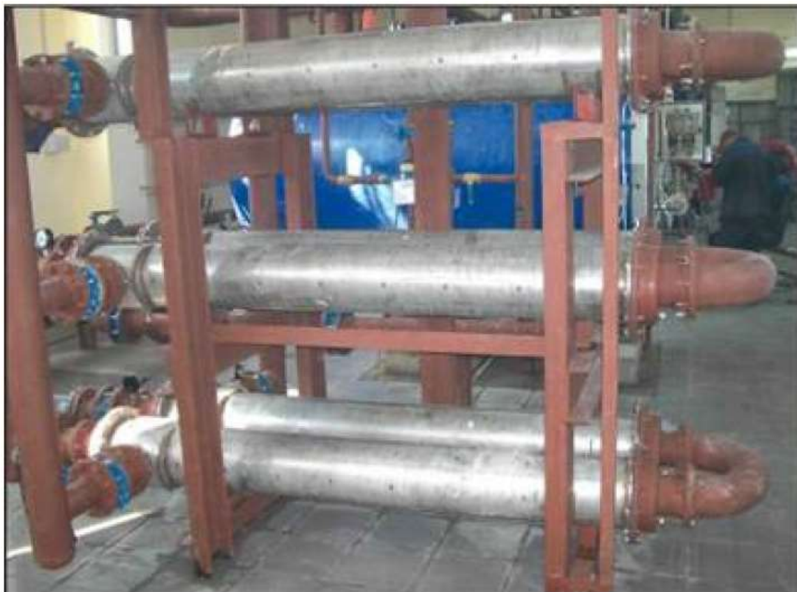
Рисунок 8 - Теплообменники ВВПИ в котельной МУП «Теплосервис»
